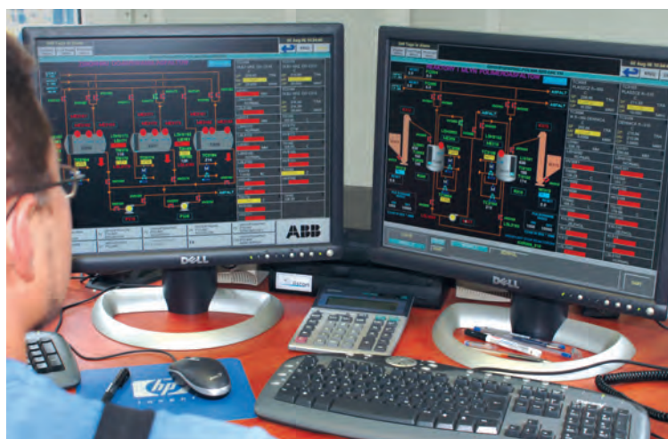
Rys. 1.4. System komputerowy DCS do sterowania produkcją asfaltów modyfikowanych ORBITON na instalacji w Płocku (fot. ORLEN Asphalt)
