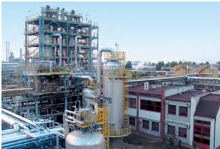
Rys. 1.2. Instalacja ciągłego utleniania – reaktory Biturox® (fot. ORLEN Asphalt)
